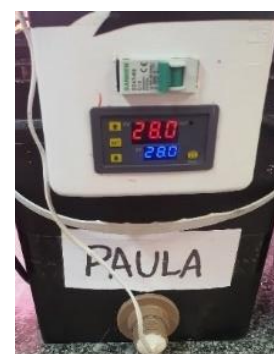
Controlador de temperatura com 2 pontos de energia Temperatura setada (EM AZUL)
