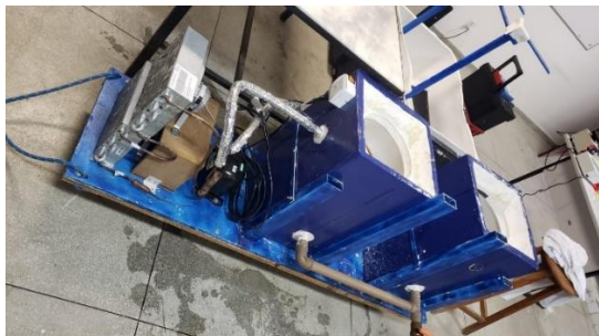
Chiller para resfriamento da água do condensador
